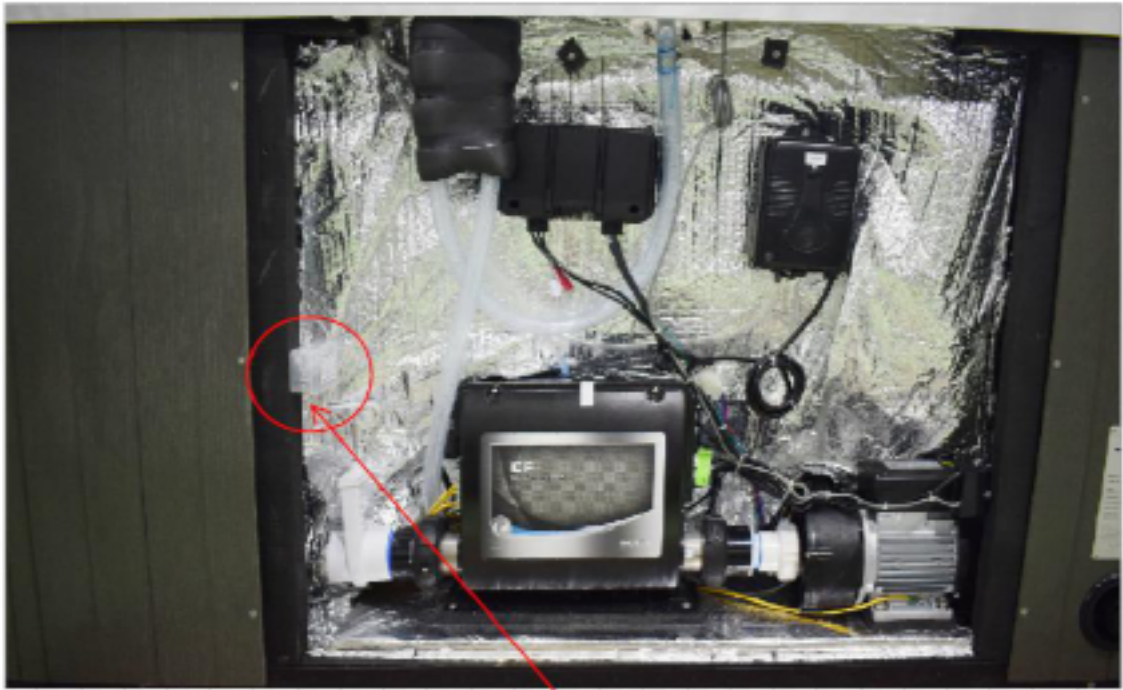
Расположение дополнительного предохранителя
